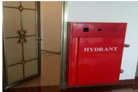
Gambar.1 Bentuk Indoor Hydrant Box
