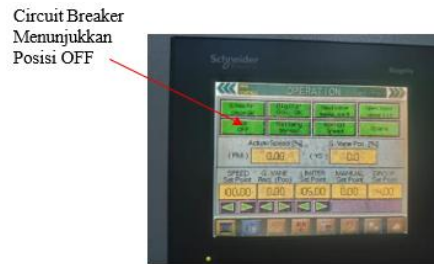
Gambar 4. Indikator circuit breaker (CB) menunjukkan posisi OFF ketika posisi guide vane tidak dalam posisi normal.
